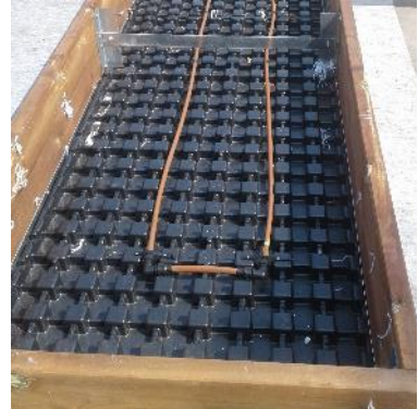
3 - Le système de drainage AQUATEC à forte rétention d'eau des jardinières potagères, et les tuyaux d'irrigation.
